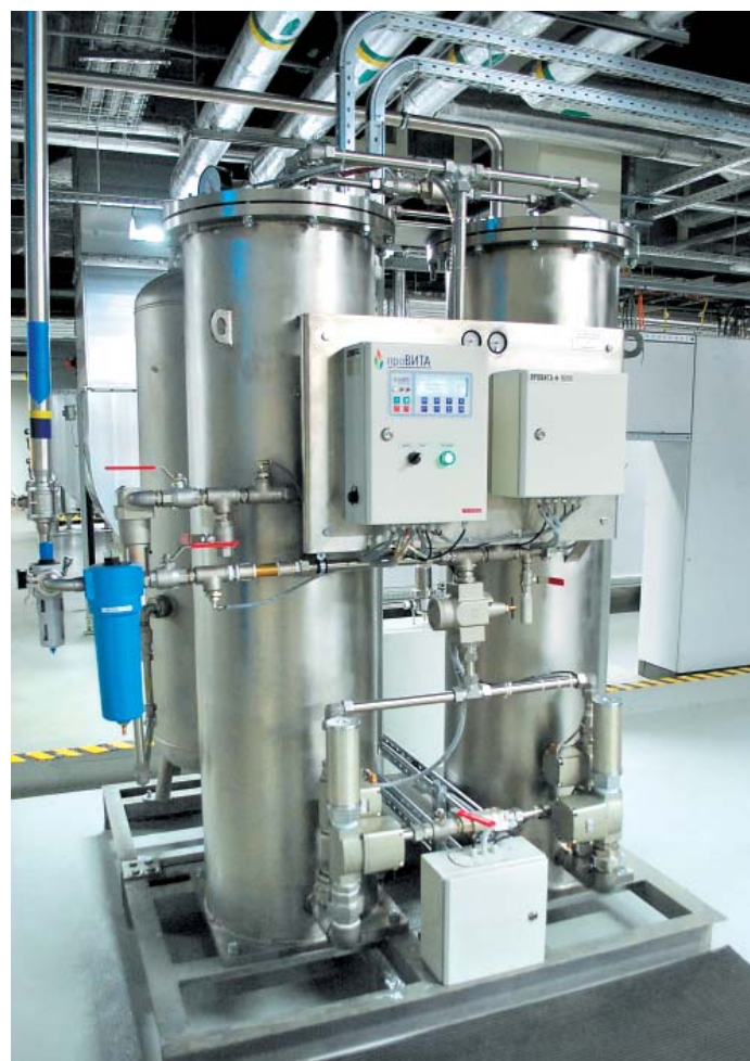
Фото 2. Адсорбционная азотная установка на одном из фарм-предприятий Санкт-Петербурга
