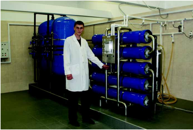
Участок водоподготовки воды для инъекций и воды очищенной
