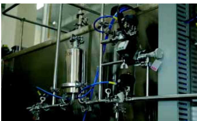
Система контроля целостности фильтра
