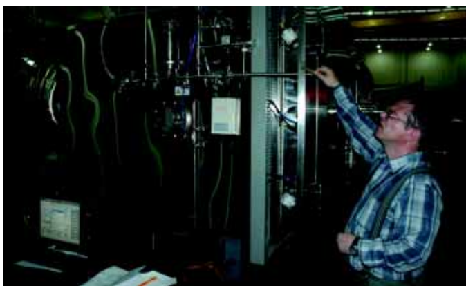
Инженер-электронщик «Холдинг «Фарм Тех» Дякин Д.М. контролирует параметры работы оборудования в процессе проверки целостности системы
