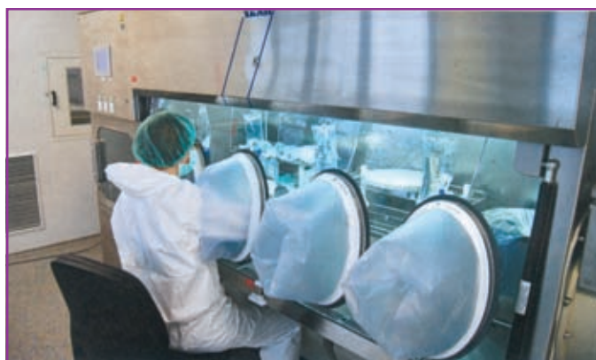
На производстве Аукамм Фарма изолятор класса чистоты «А» установлен в чистом помещении класса «D».
