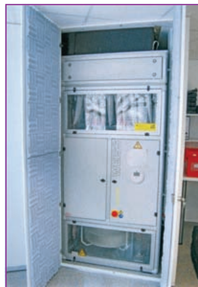
Приточный воздух для чистого помещения класса «D» пропускается через несколько фильтров H14.
